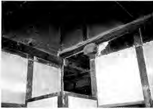
図9 ダイドコの天井を撤去したところ 土壁が黒くなっている、かつて吹き抜けになっていたことがわかる
