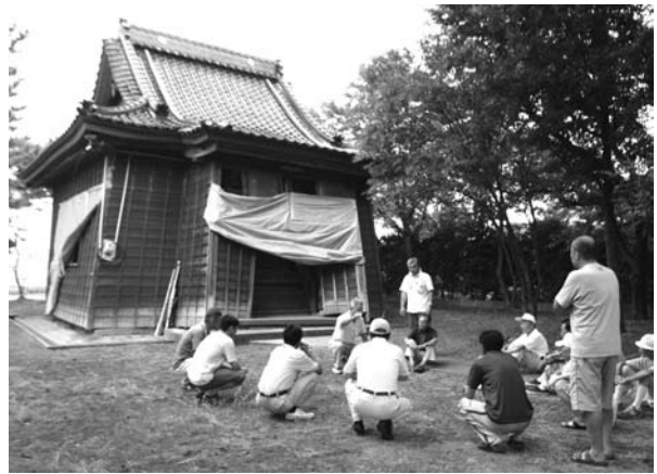
刈羽村の倒壊寸前の神社。応急的措置を施し、修復の道筋を住民に示した。
