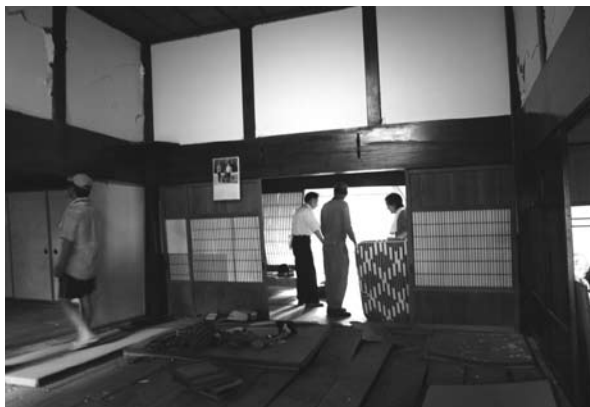
刈羽村下高町の被災した伝統民家。液状化被害により床は手ひどい被害を受けたが、柱や壁にはほとんど損傷がない。
