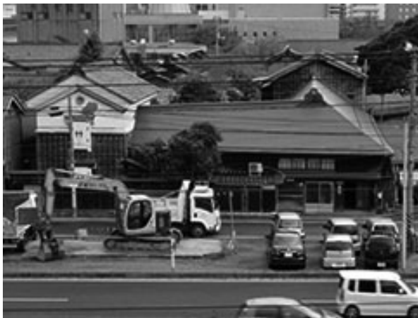
解体作業が始まった峰村家住宅。奥に見えるほんぼーと(市立図書館)までが峰村家の敷地で奥行きは 70m あります。同じく解体中の尾崎外科医院 3 階から撮影。
